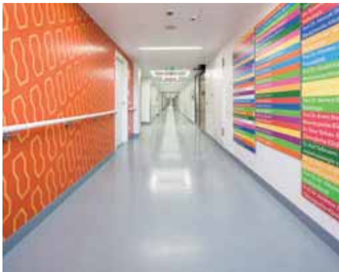
Beim Neubau des Operations- und Bettenhauses des Klinikums Offenbach entwickelte sich der „Patient Estrich“ anfangs zum Problem.
